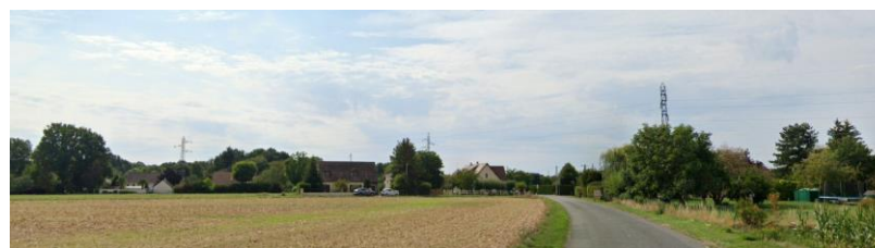
PYLONES ELECTRIQUES DE LA LIGNE 150kV EN PROVENANCE DU CHATELET-EN-BRIE A HERICY – SOURCE : STREET VIEW
