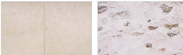
Enduit de plâtre légèrement ocré et enduit de plâtre à pierre vue ©CAUE
