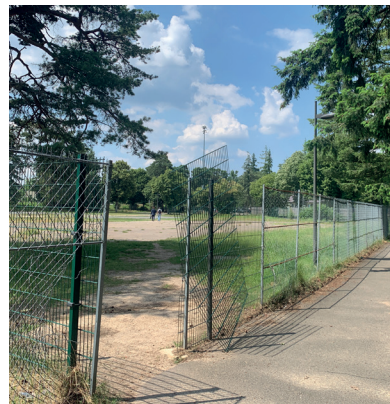
OUVERTURE NON OFFICIELLE DANS LA CLÔTURE PERMETTANT DE RACCOURCIR LE PARCOURS PIÉTON
