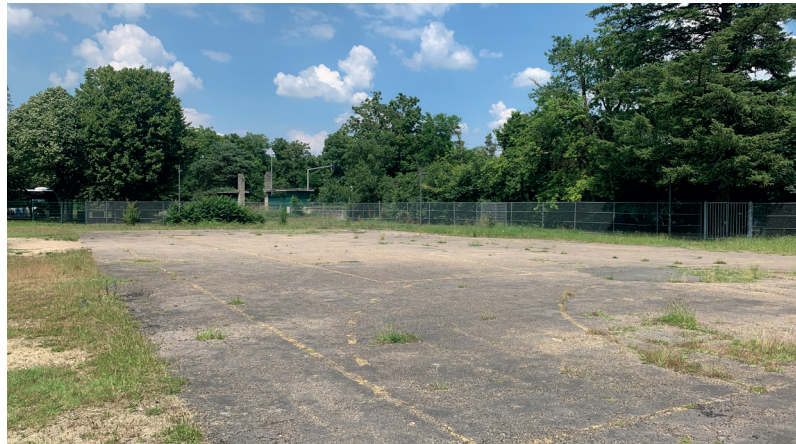
16 // Terrain dans un état de vétusté avancé
